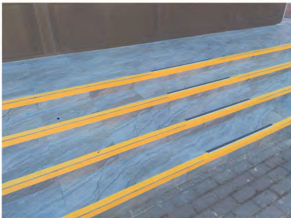
Фото 2. Є візуальні попередження на кожній сходинці
